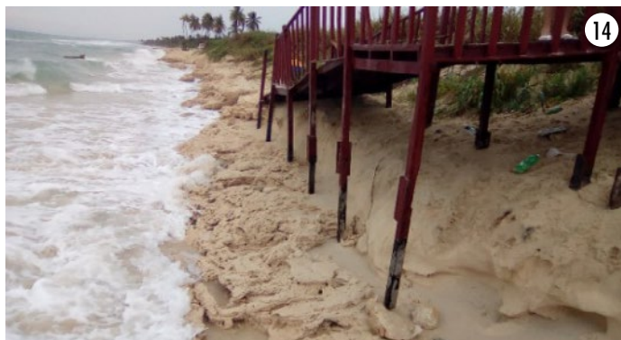
Fig. 14. Estado del sector más oriental de área de estudio provocado por el huracán Michael
