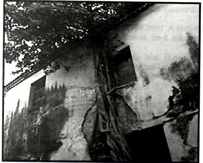
Fig. 2. Daño estructural causado por Ficus sp.
