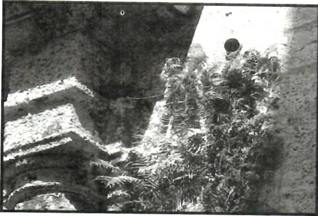
Fig. 1. Pteris vittata creciendo bajo un desagüe en la fachada de San Francisco de Asís.
