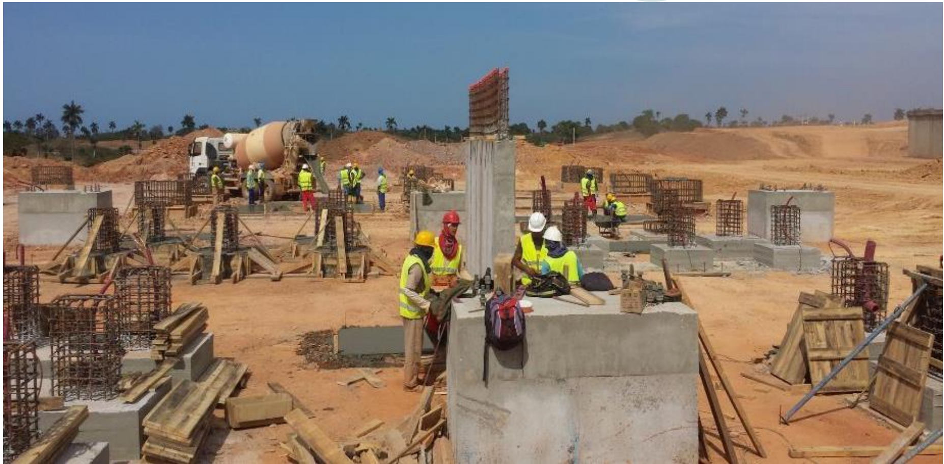
Subestación Eléctrica Planta EMINCAR. Minas de Matahambre, Pinar del Río
